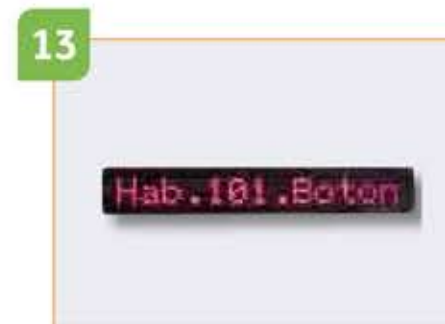
13 Letreros luminosos para pasillos. Muestra el tipo de alarma y la procedencia de la misma.
